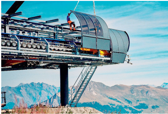
Le montage du nouveau télésiège Moay-Pasay, à Bruson a été réalisé par STA cet été.
